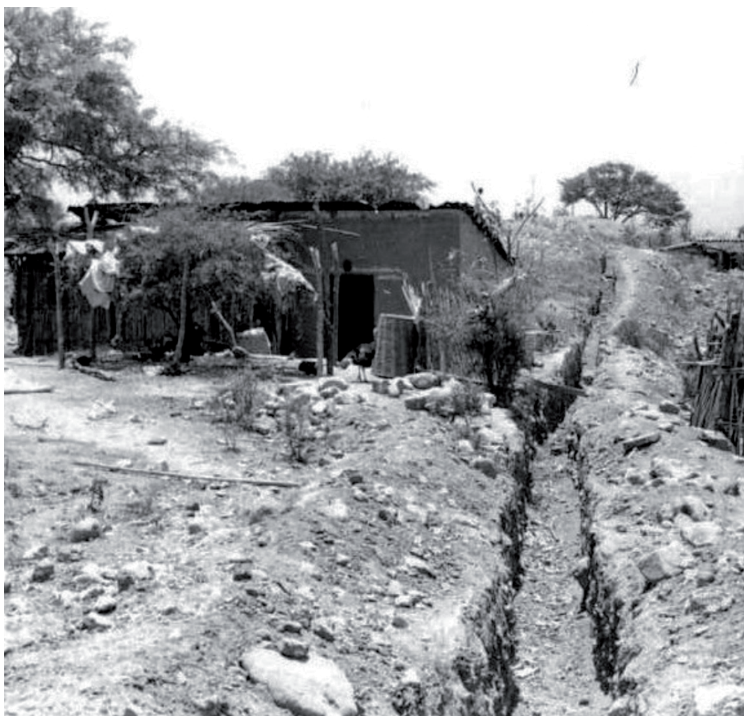
Lámina 13. El Guexe. La zanja para la tubería del agua al lado oeste del sitio, con la vivienda al lado de la cancha de juego de pelota. Vista hacia el sur. Foto de WOA.
